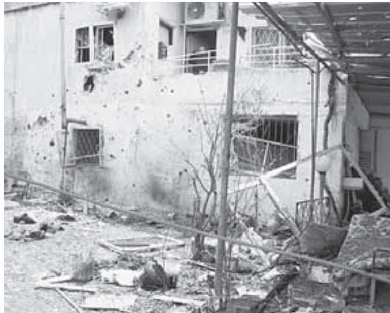
Das beschädigte Haus vom Onkel der Familie in Pekiin.
